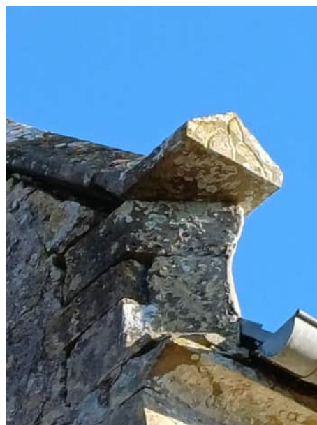
FIG. 5 – Mur pignon du chœur entaillé entre chaperon et sablière.
